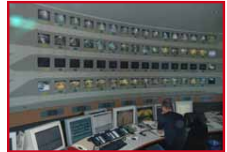
Die Monitorwand in der Tunnelzentrale
