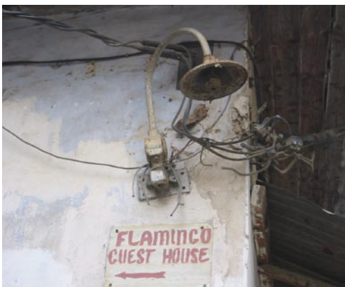
Die Elektrik entspricht nicht den VDE Vorschriften
