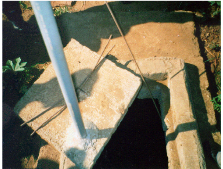
Blick in eine Klärgrube. Durch das Rohr entweichen die Klärgase
